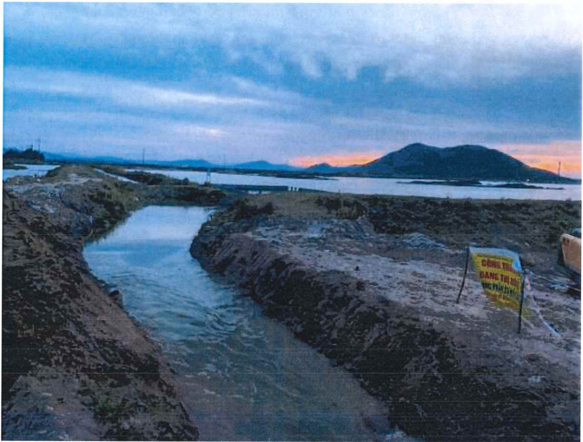
Hình 3.39. Mương hở tiếp nhận nước sau bể lắng
