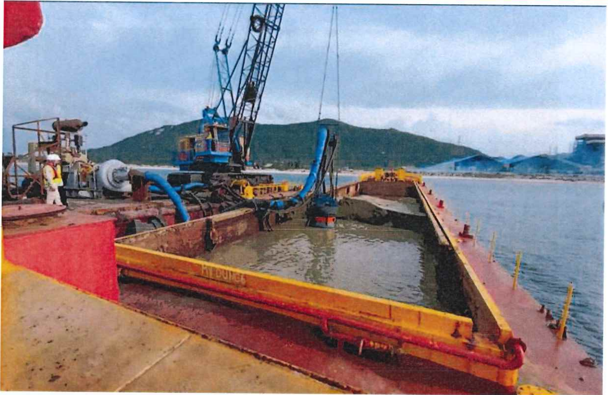
Hình 1.16. Trạm bơm (ảnh thực tế)
