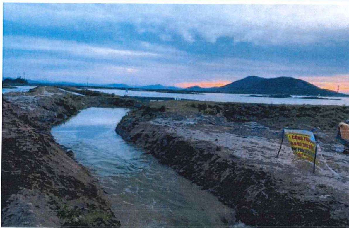
Hình 1.28. Mương hở tiếp nhận nước sau bể lắng
