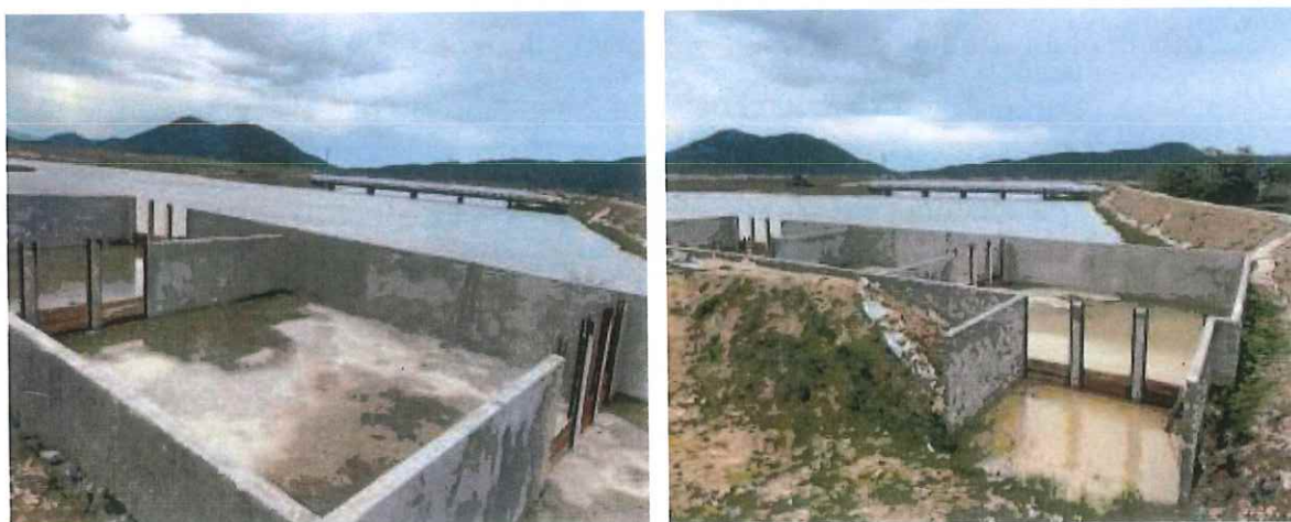
Hình 1.27. Bể lắng 3 ngăn xử lý nước rò rỉ từ bãi chứa
